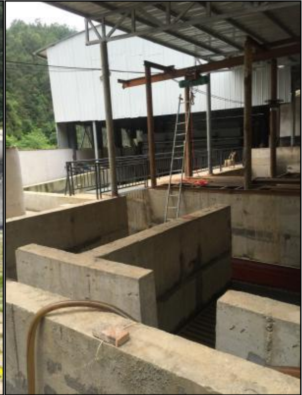
石坪尾矿库污水处理站
