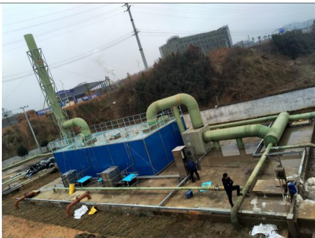
二期工程废气处理设施
