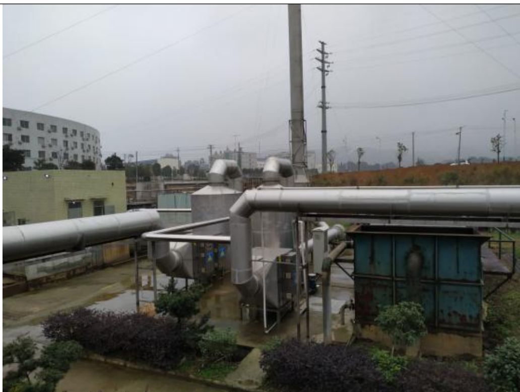
一期工程废气处理设施
