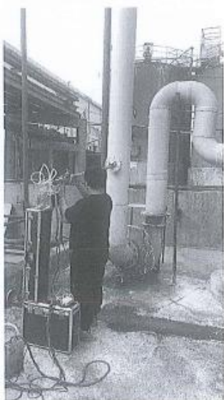
Y1:氯化尾矿因科法脱氯反应槽尾气排气筒进口
