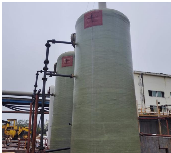
图 5 氰渣因科法反应槽尾气喷淋装置
